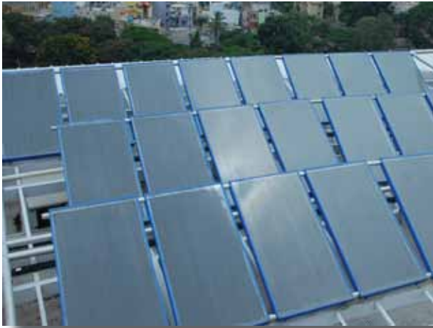
ETA Constructions, K'taka & TN - 100000 LPD
